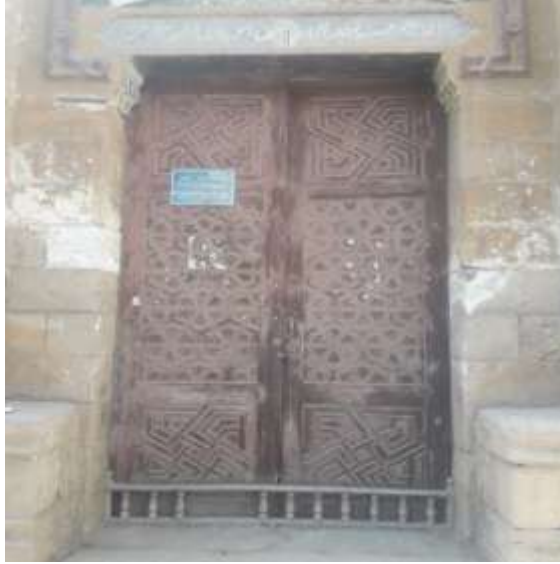
صورة رقم (٤) صورة لباب الدخول الرئيسي للجامع ويظهر على جانبية المكسلتان. (تصوير الباحث).
